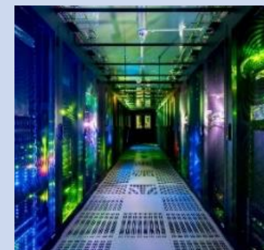
Green Datahub (Rechenzentren)
